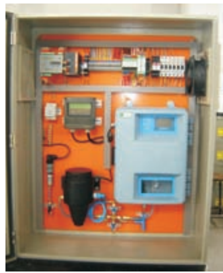
Painel de Telemetria de Qualidade de Água com Tecnologia GPRS
